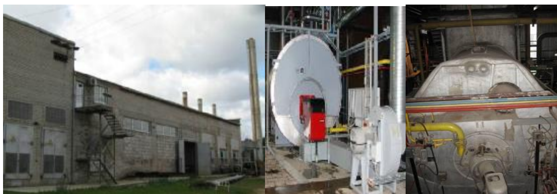
4. att. Salaspils katlu mājā esošie ūdenssildāmie katli Vapor TTKV-100-100 un KVGM - 20
